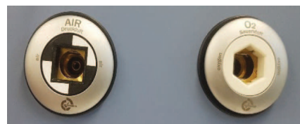
2. ábra Figyeljük meg az orvosi levegő és az oxigén színekódolt és eltérő formájú csatlakozóit!
